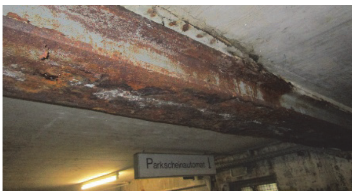
Korrodierte Stahlunterzüge vor der Instandsetzung
