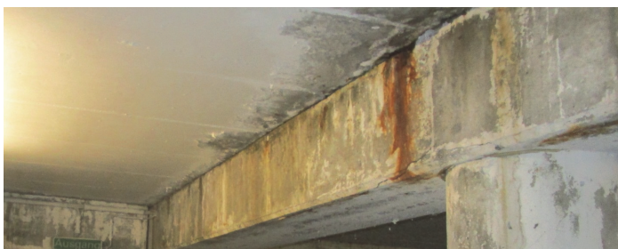
Stahlbetonunterzug vor der Instandsetzung
