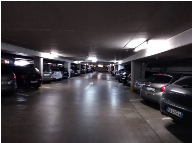
Parkgasse vor der Instandsetzung (Foto: AMP)
